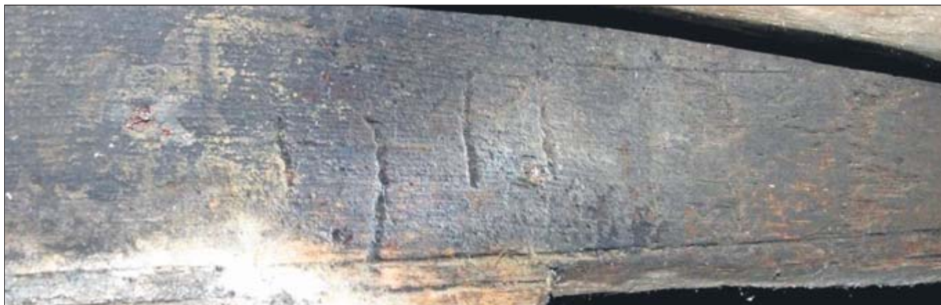
Man muss schon ganz genau hinschauen, um die Ritzungen auf diesem Eichenbalken zu erkennen. Mittlerweile konnte diese Bauinschrift zweifelsfrei als Jahreszahl 1577 identifiziert und damit auch das Entstehungsjahr des Gebäudes exakt bestimmt werden.
